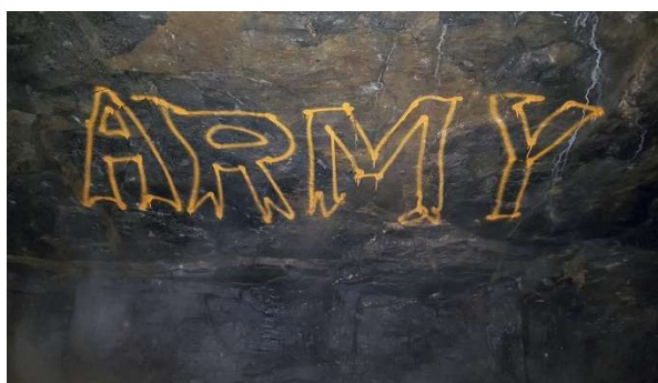
Obrázek 11 Posprejované stěny Franc France
