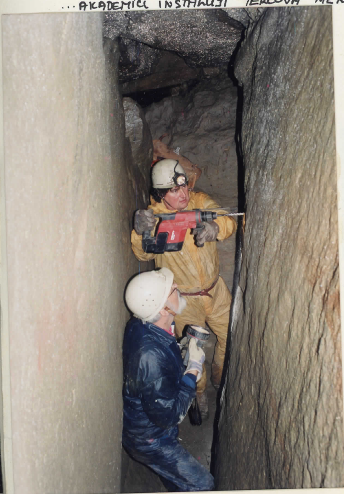
...AKADEMICI INSTALUJÍ TERČOVÁ MĚŘIDLA.
